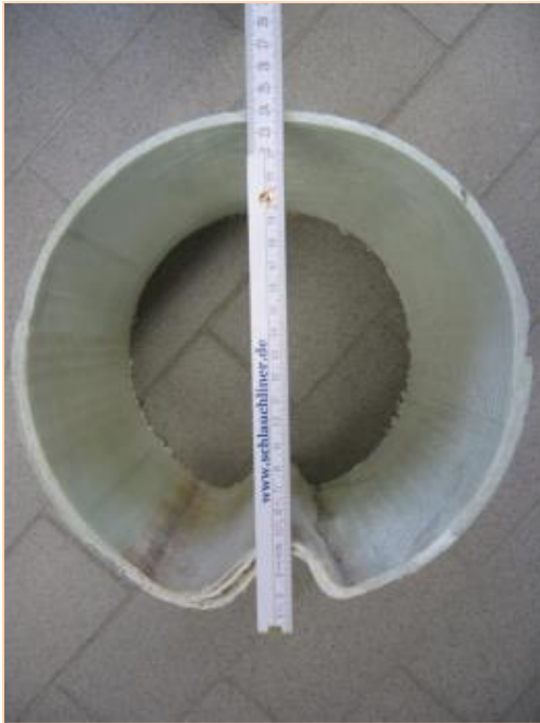
Falte im Sohlbereich einer GFK-Schlauchlinerprobe mit Delaminierung der Glaslagen.
